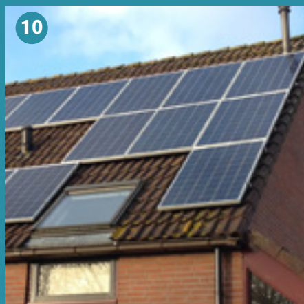
10 Zonnepanelen ad-hoc op het dakvlak
