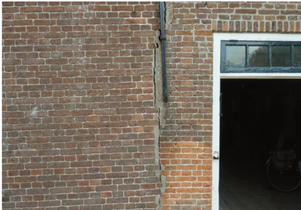
Afb. 4.3 Foto van de verticale bouwnaad in de westgevel. Rechts is het oudere boerderijgedeelte uit 1871 en links is de verlenging uit 1889 te zien (het metselwerk wijkt onderling af). De verzakking van de diverse bouwdelen is hier ook goed zichtbaar.
