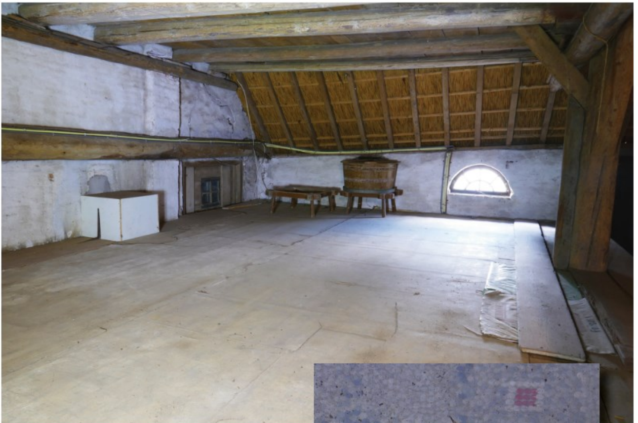
Afb. 4.24 Foto van het hogere zolderdeel 1.01a, dat vroeger voor hooiopslag diende. Aangezien hieronder gewoon wordt, werd de vloer met zeil afgedekt (zie inzet).
