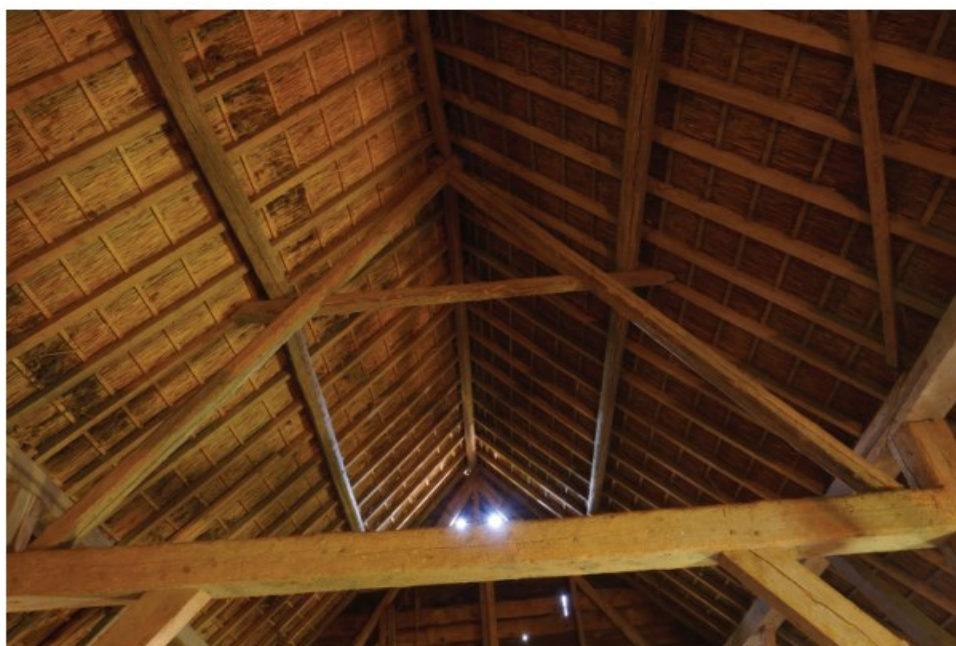
Afb. 4.20 Foto van de bovenste geleding van één van de oude spanten, welke bestaat uit een schaarspant met overgekeekte spantbalk.
