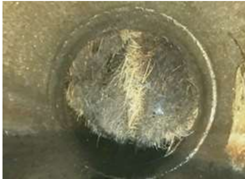
wortels in het riool
